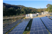
発電出力4MWの分散型パワコンシステムを採用した赤穂エナジーパーク (日本・赤穂市)
