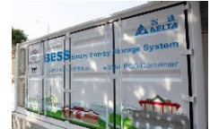
金門夏興発電所へ2MW/1MWh蓄電システムを提供、離島の独立電力網安定に寄与 (台湾)
